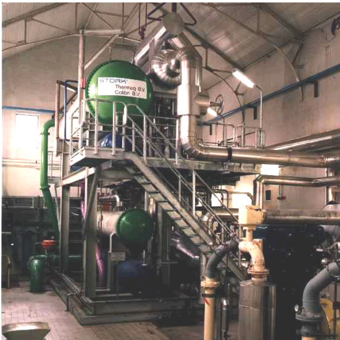
ARP-C-14 instalada en una fábrica de margarinas en Rotterdam, 1400 kW a -23^{\circ}\text{C} .
