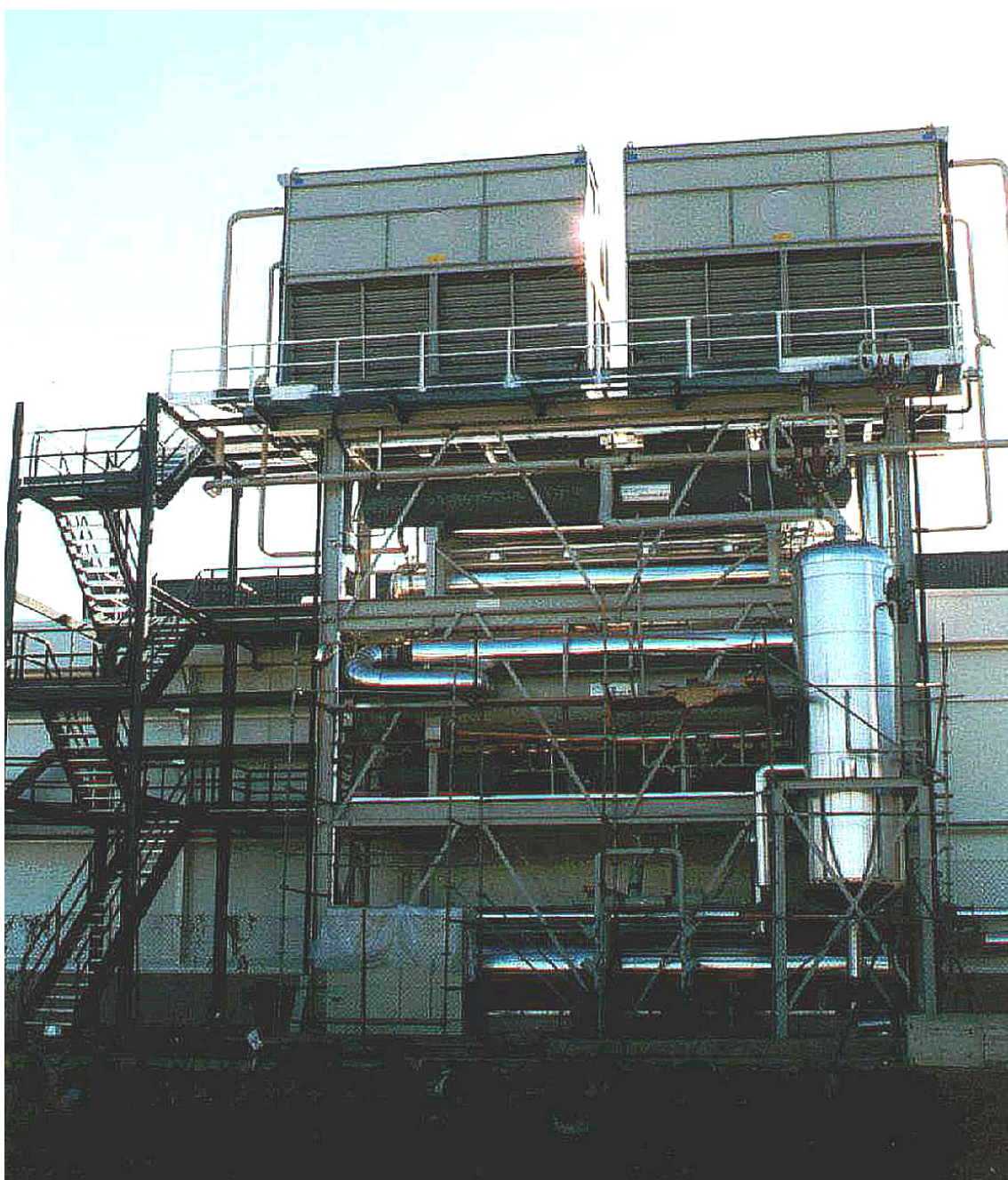
ARP-M-25 instalada en una empresa cárnica en Rioja, 2500 kW a -10^{\circ}\text{C} .
