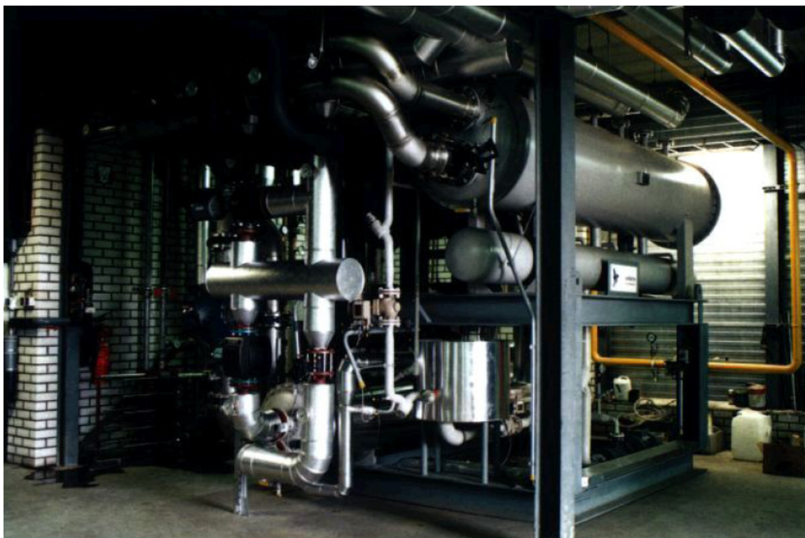
ARP-S-2 instalada en una empresa cárnica en Holanda, 250 kW a -10^{\circ}\text{C} .
