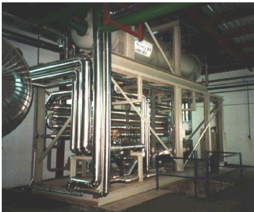
ARP-M-10 instalada en una fábrica de congelados de verduras en Talavera de la Reina, 700 kW a -30^{\circ}\text{C} .
